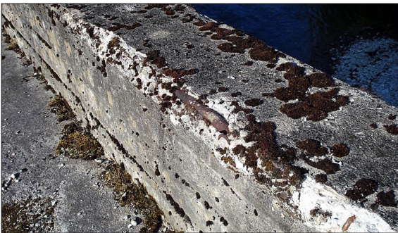
Abplatzung mit sichtbarem Bewehrungsstab
