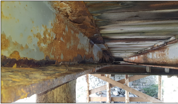
Untersicht bestehende Brücke (Starke Korrosion) Eigene Darstellung
