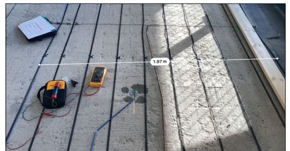
Kontrolle der eingebauten Referenzelektrode im Parkhaus. Eigene Darstellung
