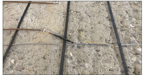
Anodenanschluss des kathodischen Korrosionsschutzsystems. Eigene Darstellung
