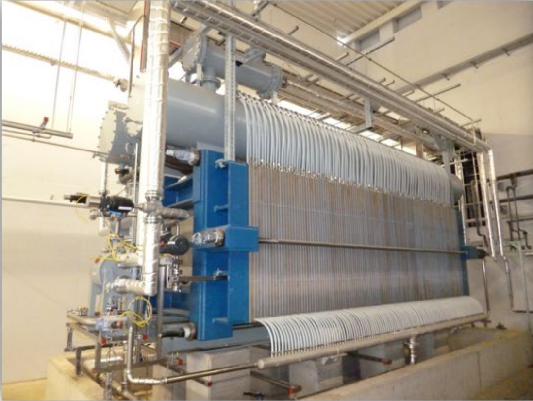
Elektrolyseure (3 x 2 MW)
