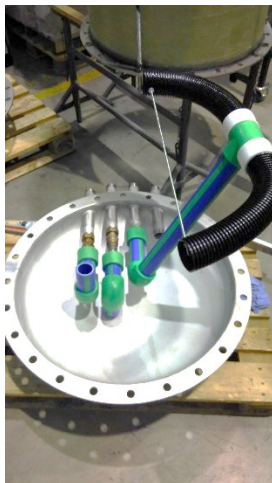
Abbildung 64: Deckel mit Beladung Brauchwarmwasserzone (rechts), Entnahme Brauchwasserzone (links), Entlüftung MAG Anschluss (Mitte)
