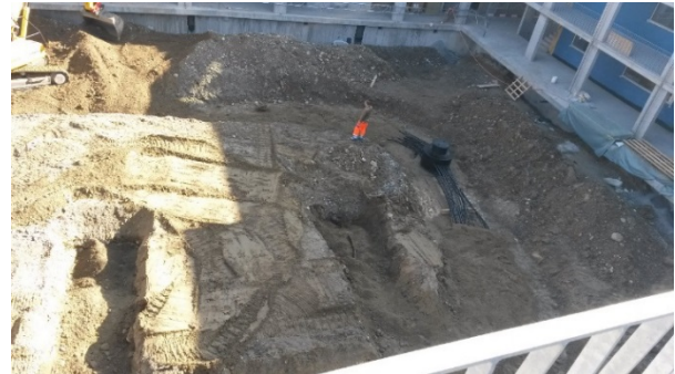
Abb. 10 Sammelstelle der 14 Erdsonden im Innenhof von Haus B
