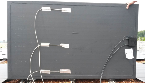
Abb. 15 PV Modul, 3 Temperatursensoren an der Rückseite
