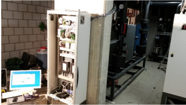
Abb. 13 Schaltschrank im Technikraum, bei Inbetriebnahme
