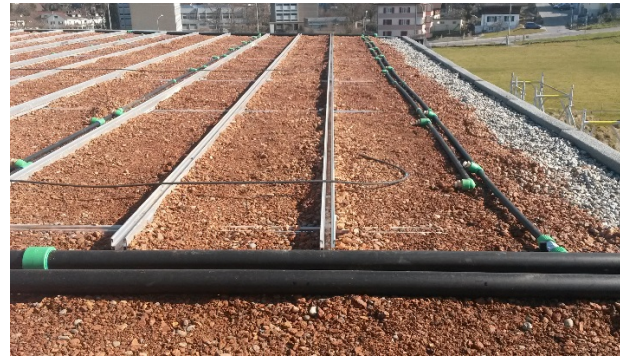
Abb. 7 Verrohrung für das PVT Feld auf Dach 3
