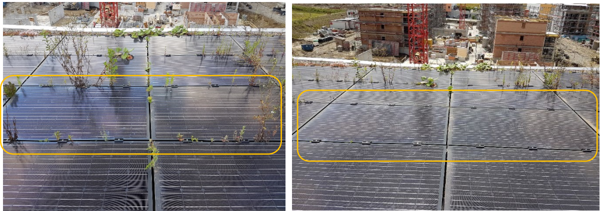
Abb. 28 Bilder des Pflanzenwachstums bei den beiden separat vermessenen Modulen (rechts wurde die Begrünung bei einer Dachbegehung rundum die beiden Module entfernt)
