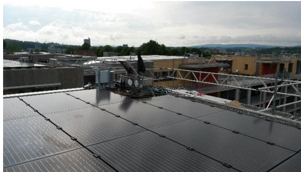
Abb. 2 PVT Kollektoren auf Teildächern von Gebäude B
