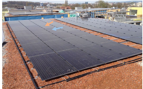
Abb. 16 fertig installierte Hybridanlage auf Haus B, der rote und blaue Pfeil zeigen auf die zwei separat gemessenen Module (PV und PVT)
