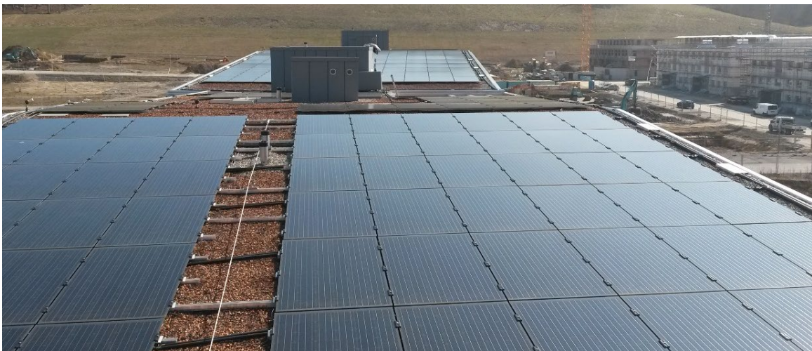
Abb. 5 Ein Teil der PVT Anlage auf dem Dach von Haus C
