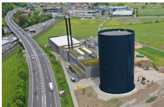
28'000 m 3 Speicher der Agro Energie Schwyz AG nach Fertigstellung
