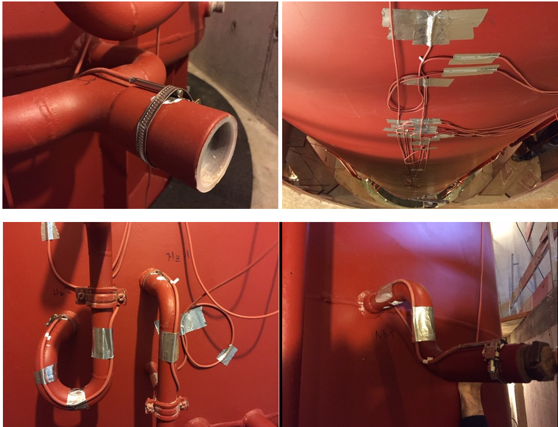
Abbildung 4: Installation der Temperaturfühler am Speicher und an den unterschiedlichen Kreisläufen.
