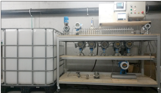
Membrantestanlage komplett, links IBC-1-m 3 -Feed-Tank, rechts ist die aufgebaute Anlage.
