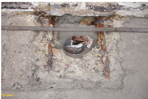
Korrosion durch Chloride an der Zugbewehrung im Bereich eines Wasserablaufs
