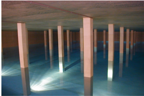
Trinkwasserbehälter mit einer zementgebundenen Auskleidung
