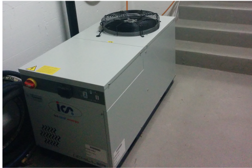
Neu dimensionierte Kältemaschine.
