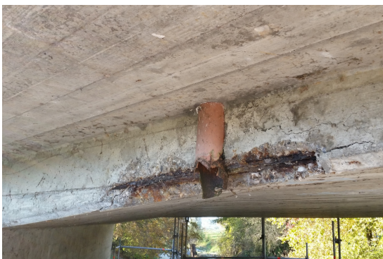
Betonabplatzungen und freiliegende, korrodierende Bewehrung auf der Brückenunterseite
