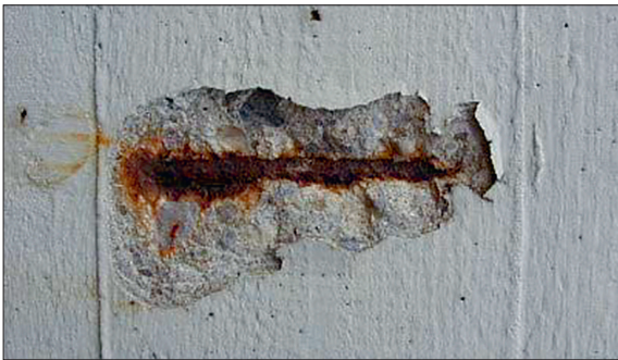
Schadensbild infolge Karbonatisierung des Betons
