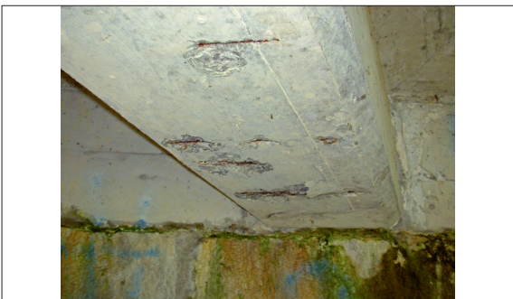
Betonabplatzungen über korrodierender Bügelbewehrung am Trägerrost
