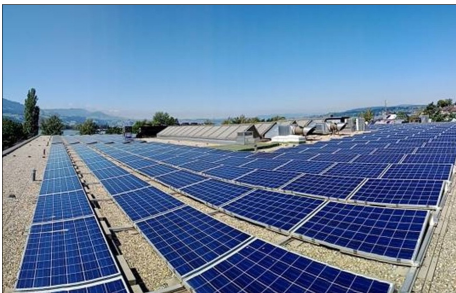
PV-Anlage HSR/OST Eigene Darstellung
