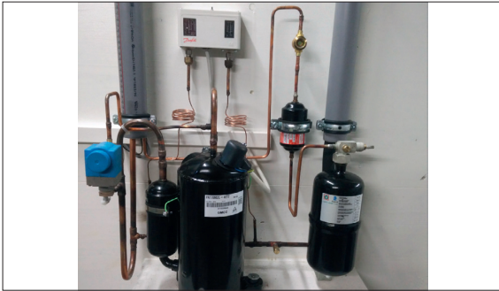
Wärmepumpe mit R410A (Wärmeleistung: 4,7kW, COP 4,3)
