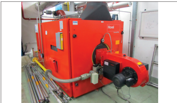
Gaskessel der Energiezentrale Ost mit einer Leistung von 1,8 MW
