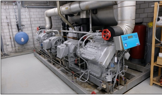
Abbildung 1: Eine der zwei Kältemaschinen Eigene Darstellung
