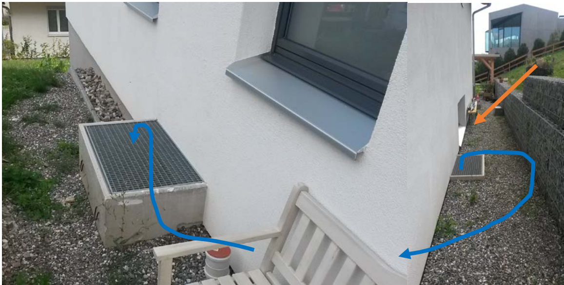
Abbildung 41: Vermuteter Luftkurzschluss zwischen Luftansaug- (links) und -ausblaskanal rechts mit zusätzlichem Kaltluft-effekt durch abfallenden Hang, Objekt 5
