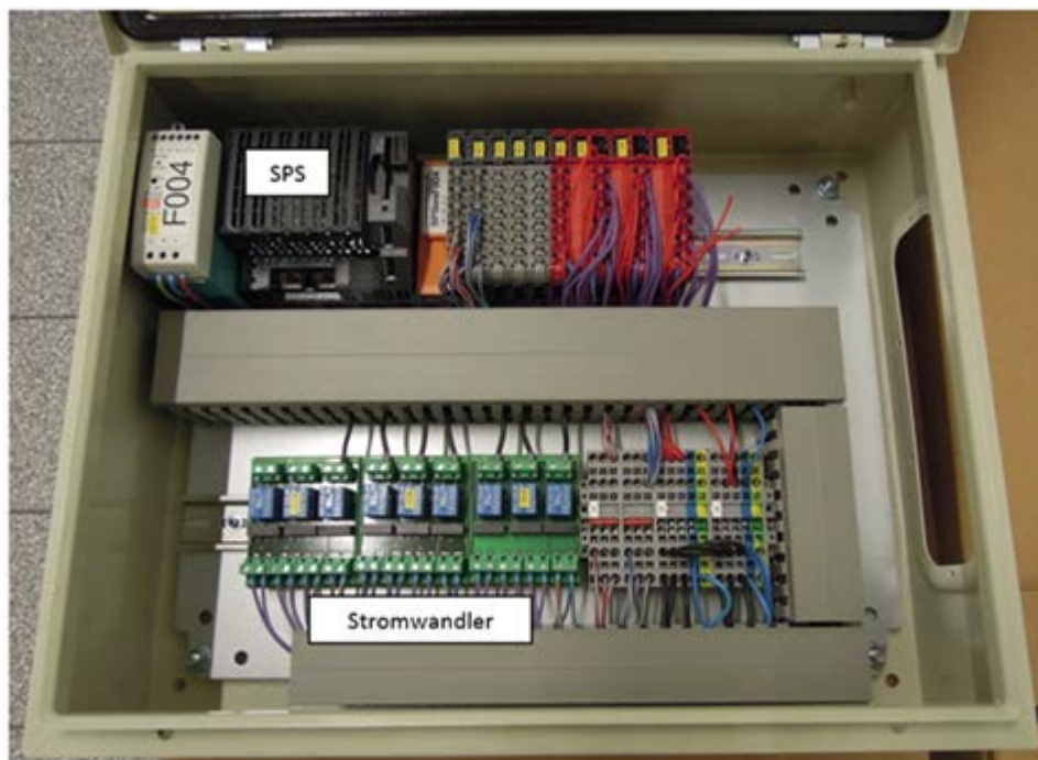
Abbildung 48: Schaltschrank der Messanlage F004_2017_SW
