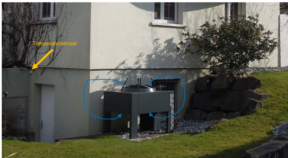
Abbildung 43: Aufstellung Ausseneinheit mit Ventilator und Gartenmauer, Objekt 8
