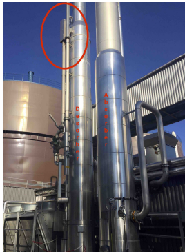
Die Biogas-Aufbereitungsanlage im Werdhölzli, rot eingekreist ist der Austrittspunkt des CO 2
