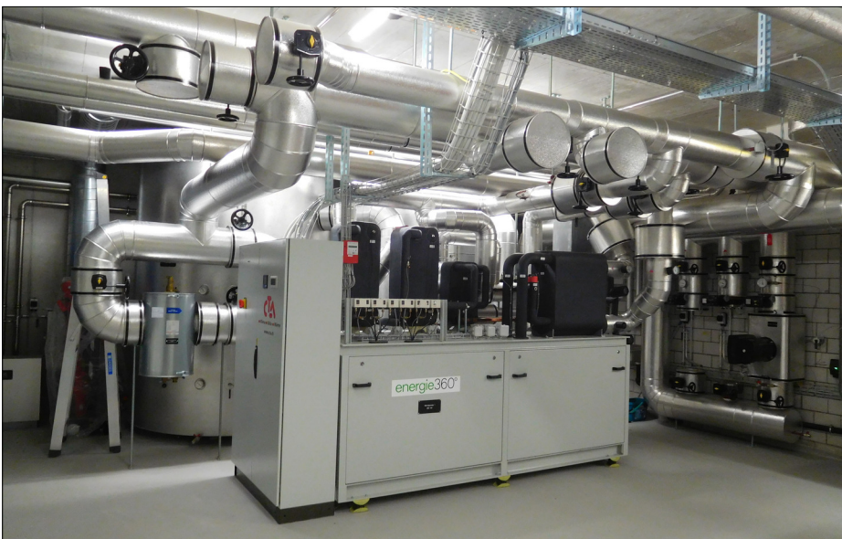
Wärmepumpe in der Energiezentrale Eigene Darstellung
