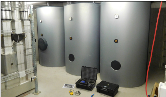
Installation Temperaturmessung Eigene Darstellung
