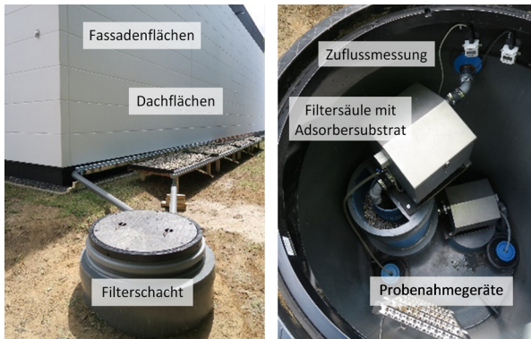
Filterschacht mit angeschlossenen Flächen (links) sowie Filter und Geräteinstallation im Schacht (rechts).
