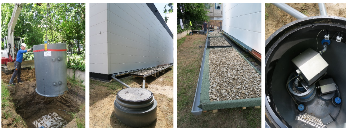
Abbildung 1: Pilotinstallation des Regenfilters, an den 150 m 2 Fassadenfläche mit Abflussrinnen aus Zink und Kupfer, 2 Testflächen mit Bitumenbahnen sowie 2 Testflächen mit EPDM-Bahnen angeschlossen sind.
