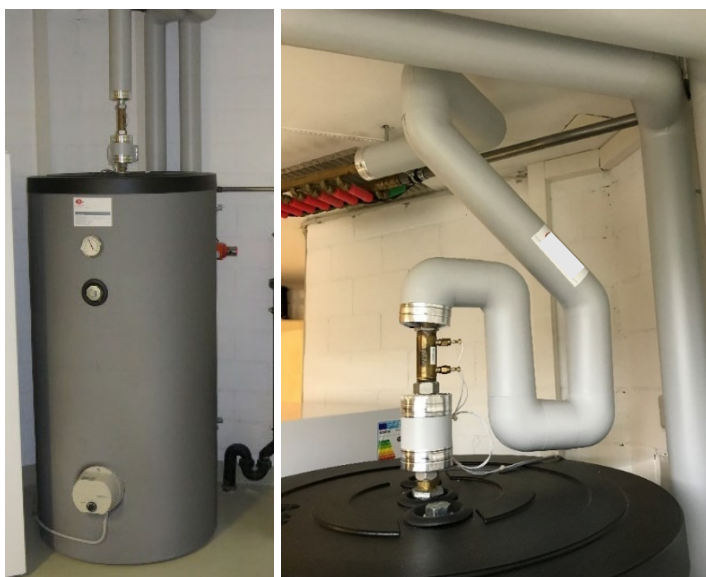
Abbildung 22: Trinkwarmwasser Speicher Anlage 20. Rechts nachträglicher Einbau eines Siphons. Direkt am Abgang die zweifache redundante Temperaturmessung
