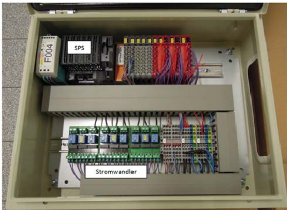
Abbildung 32: Schaltschrank der Messanlage F004_2017_SW
