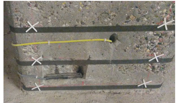
Abb. 1.2 Ungenügende Rauigkeit im Sockelbereich
